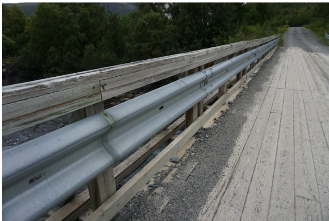
Bilde 19: Rekkverk; Råte, svakt
