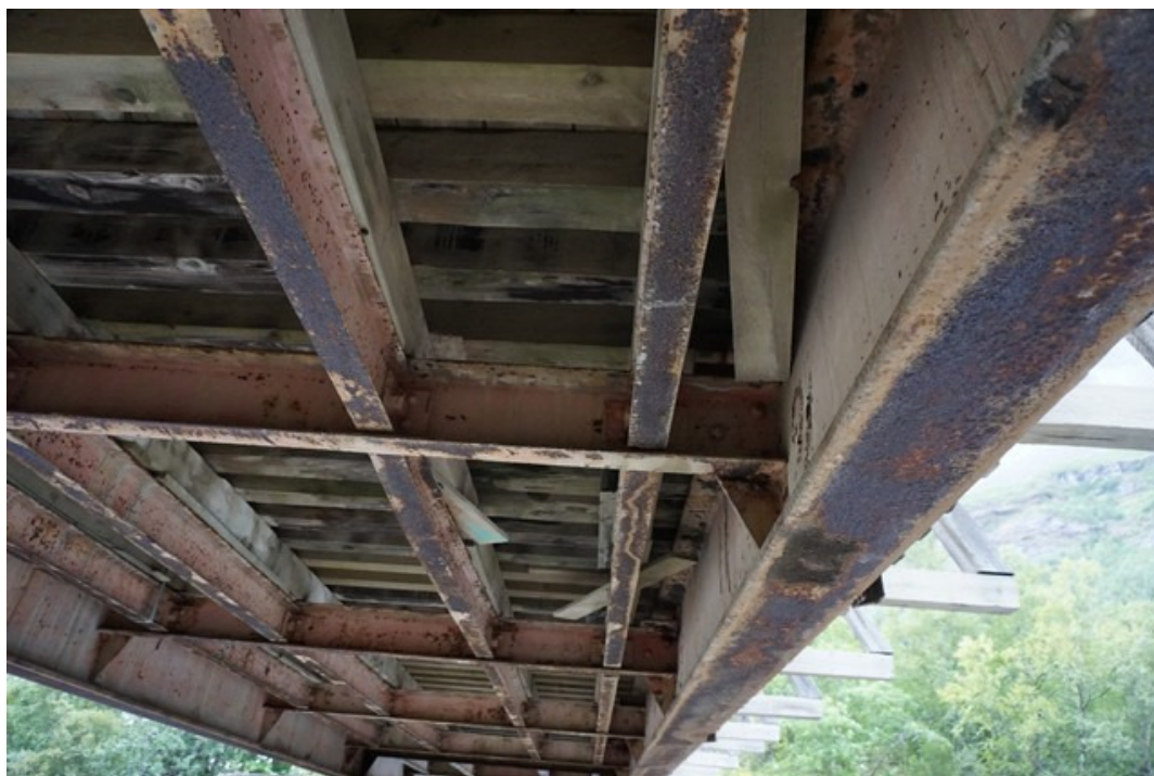
Bilde 11: Hovedbjelker; Korrosjon
