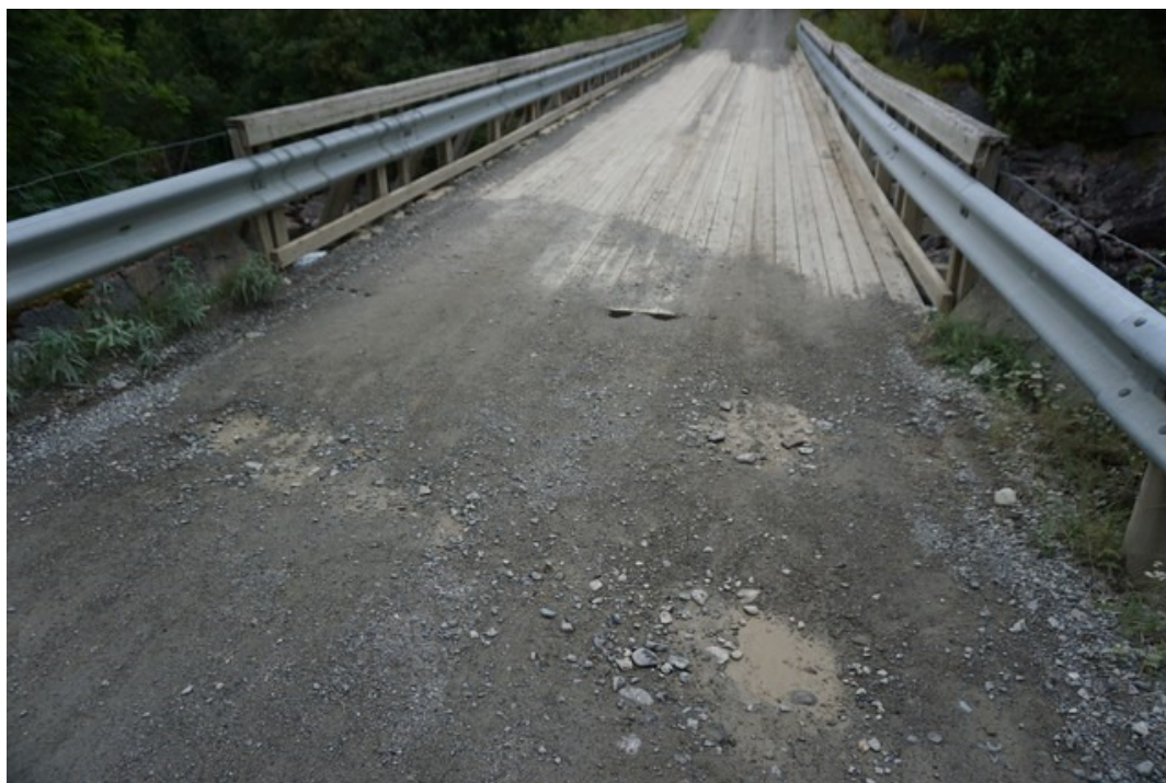
Bilde 15: Slitelag; Oppflising, sporslitasje og ujevnheter
