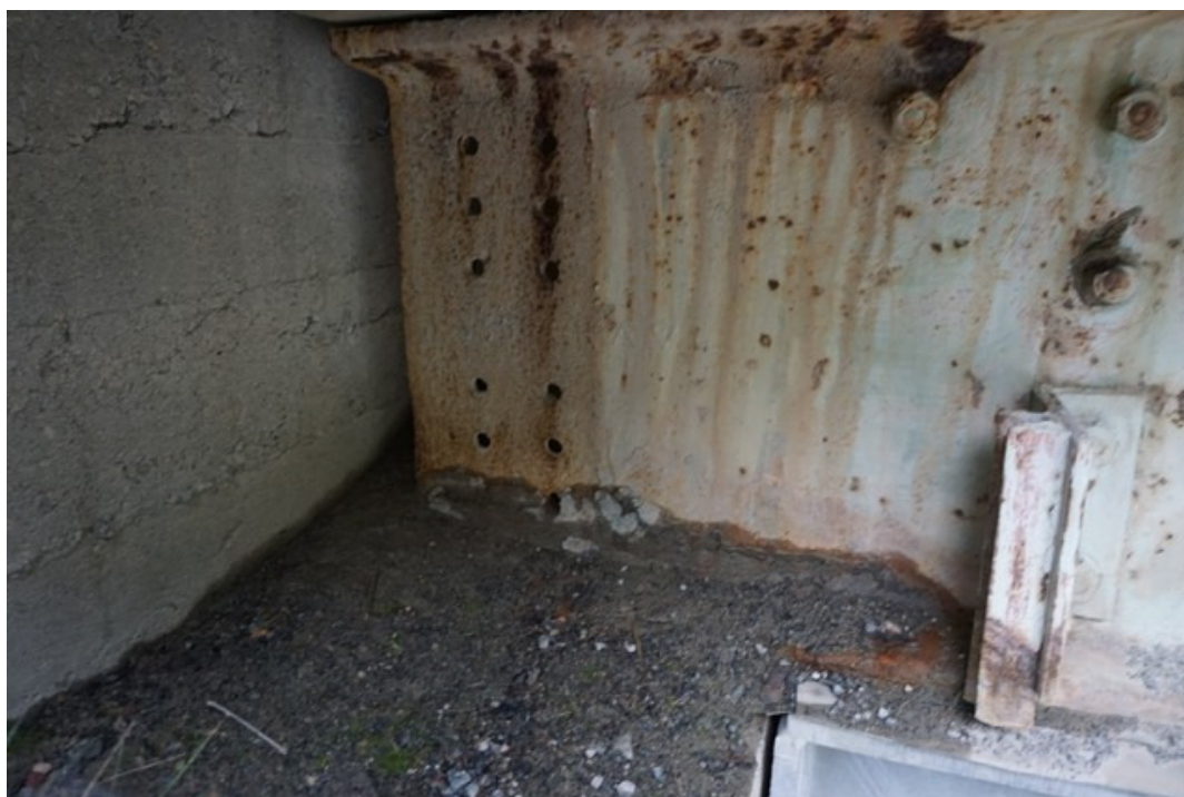
Bilde 12: Hovedbjelker; Korrosjon
