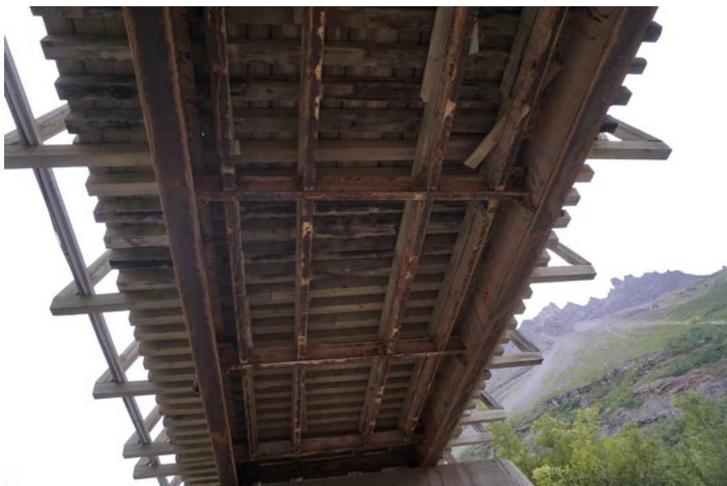
Bilde 10: Hovedbjelker, tverrbærere og sekundærbærere; Korrosjon
