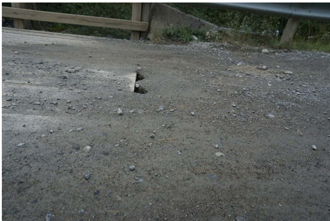
Bilde 17: Slitelag; Dårlig overgang/hull
