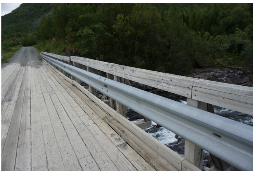
Bilde 18: Rekkverk; Råte, svakt
